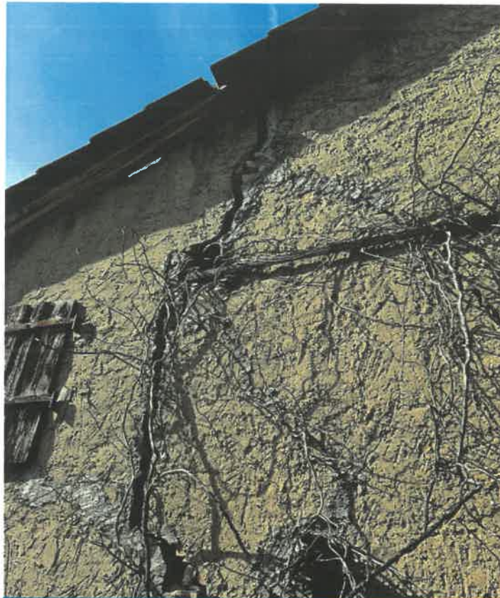
F3 Detailansicht Vertikal- riss Übergangsbereich Scheune – Anbau Rissweite 4-5cm
