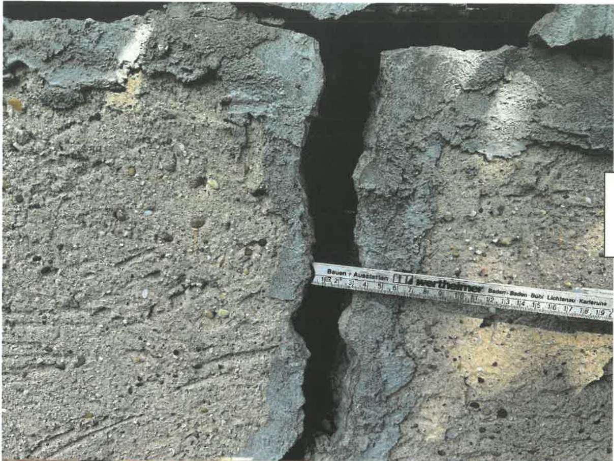
F7 Rissbreite Vertikalriss Traufwand
