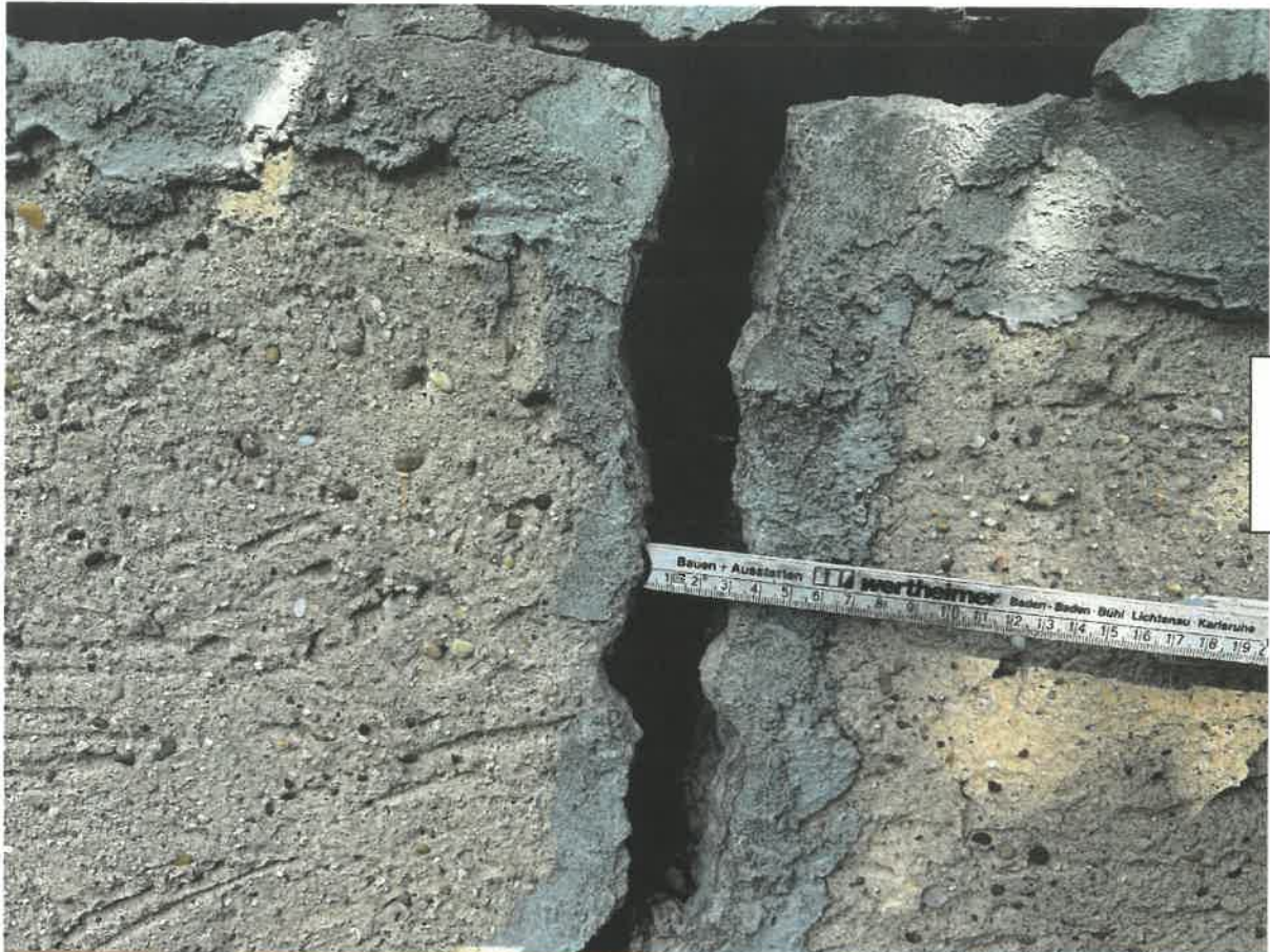
F7 Rissbreite Vertikalriss Traufwand
